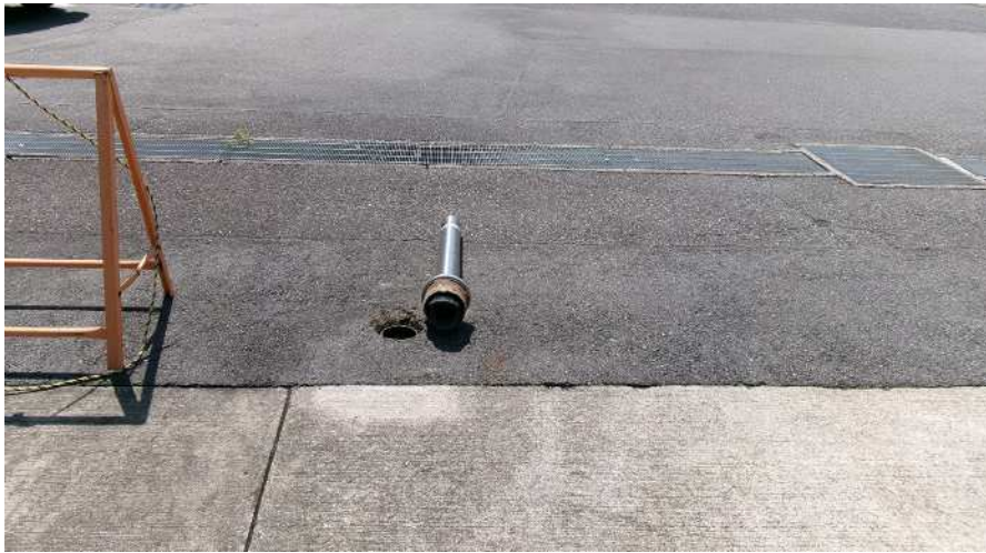
車止め 破損状況②
