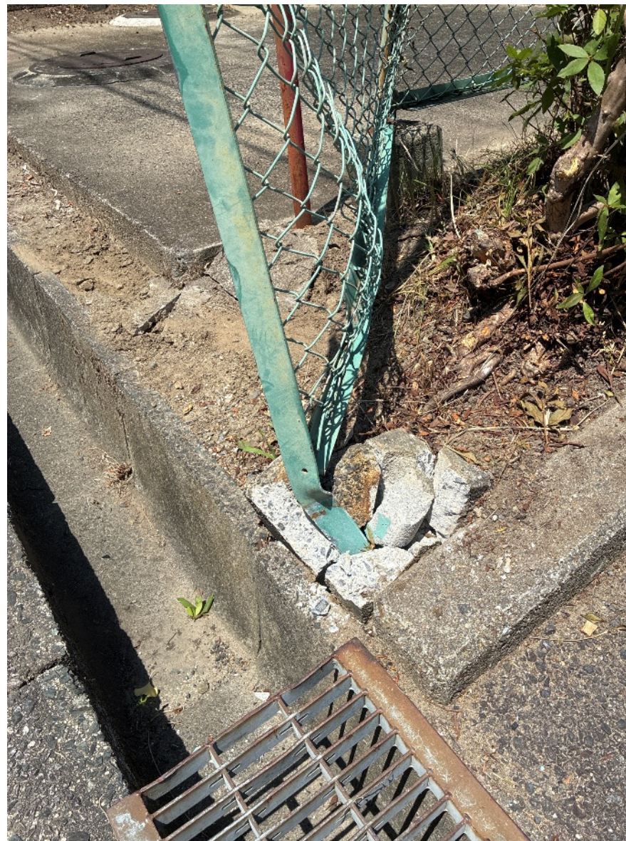
ネットフェンス被害状況（拡大）
