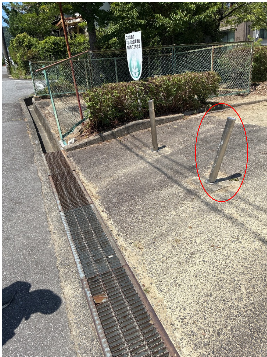
車止め被害状況
