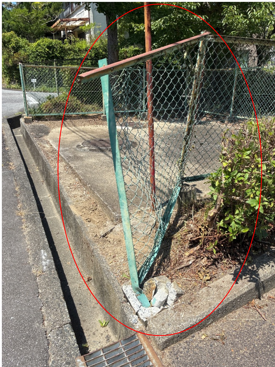
ネットフェンス被害状況
