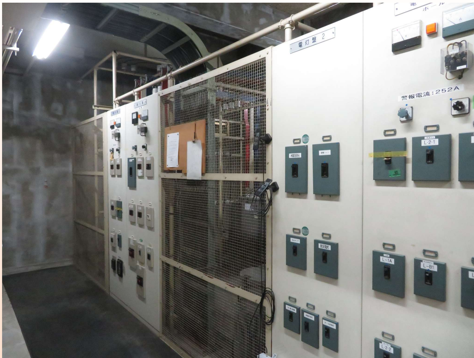
建設時からの受変電設備 保全寿命17年オーバー
