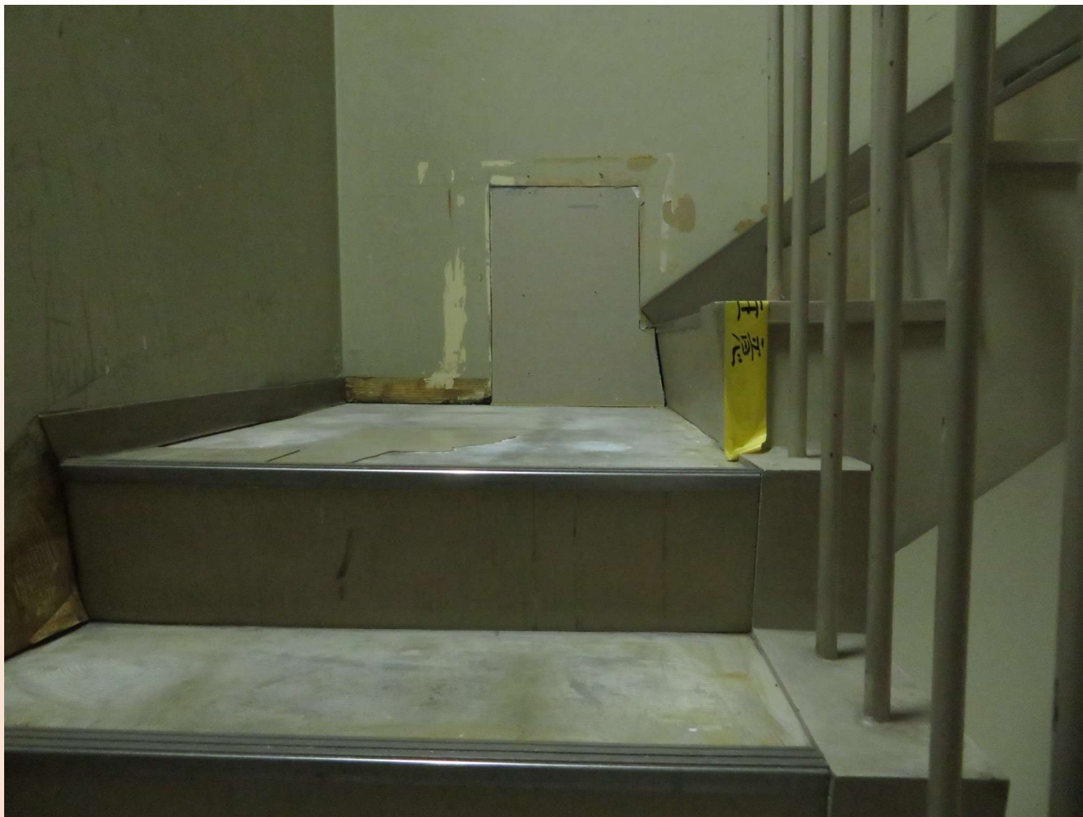
頻繁に続く雨漏りによる床面タイルの剥離
