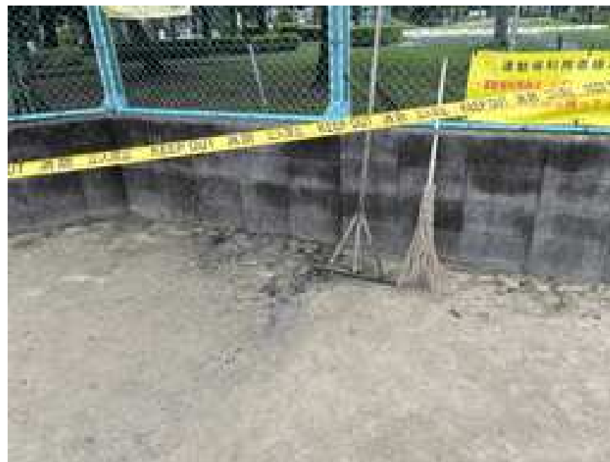
被害状況（拡大）
