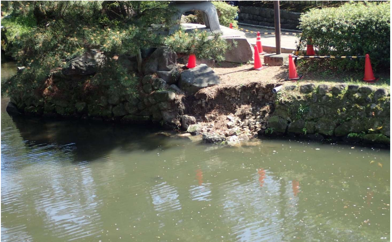
写真1 崩落後 西から撮影
