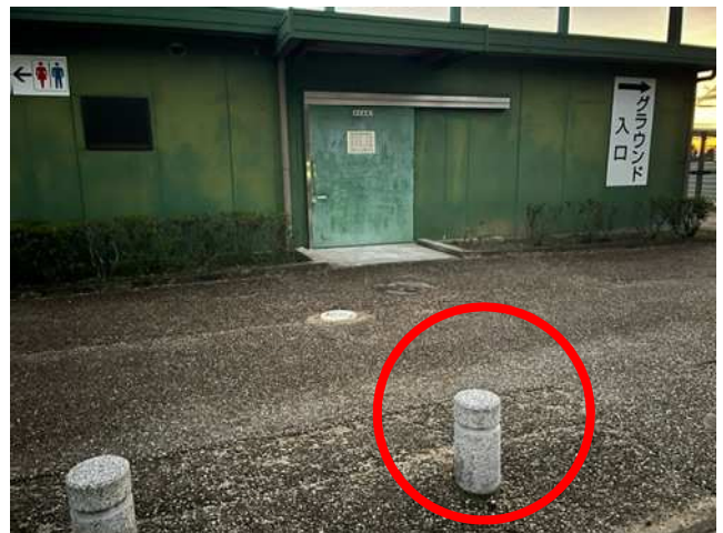
破損ボラード②
