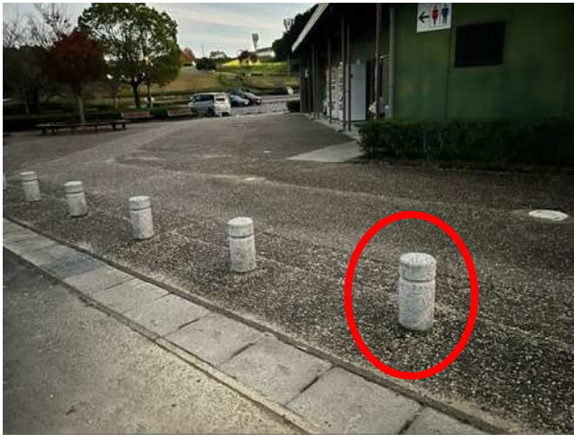
破損ボラード①
