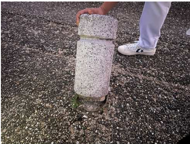
破損ボラード 近景
