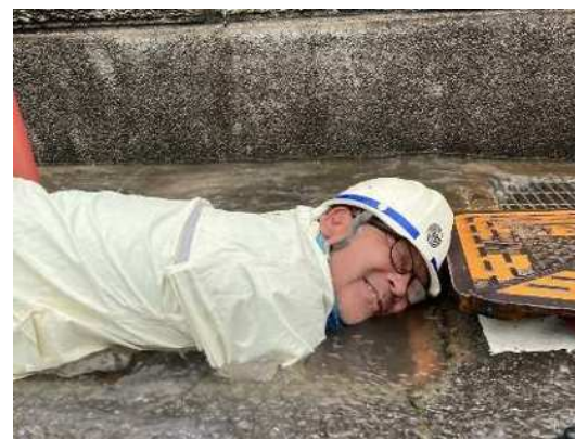
漏水により水があふれる消火栓弁室の修繕
