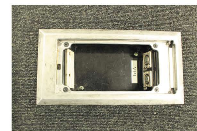
床埋め込みアース有コンセント（開）
