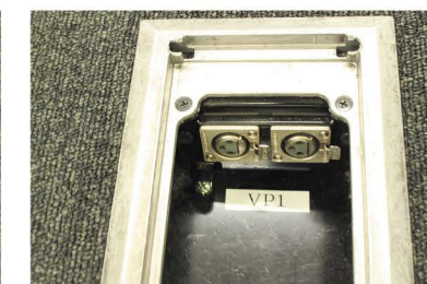
床埋め込みアース有コンセント（内部）
