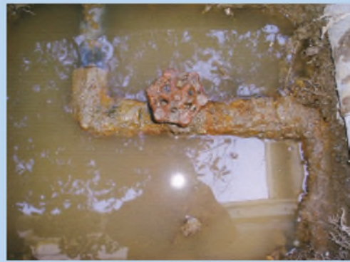
給水管の漏水
